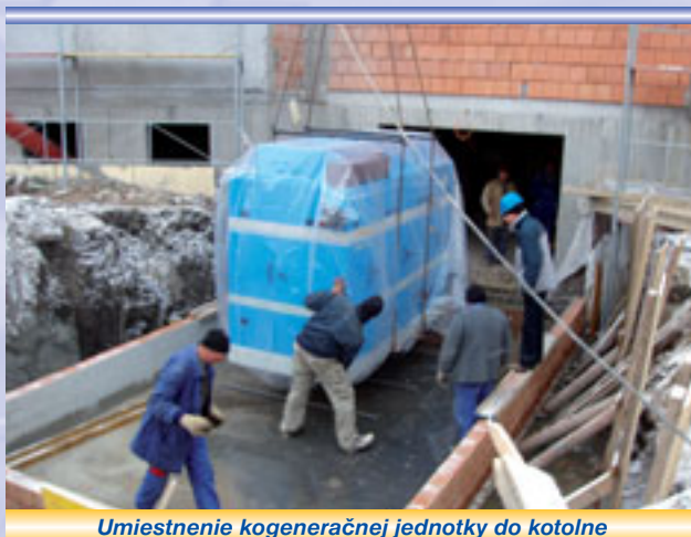
Umiestnenie kogeneračnej jednotky do kotolne
