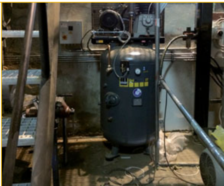
Kompresor pre zabezpečenie stlačeného vzduchu pre čistenie rúrok kotlového výmenníka
