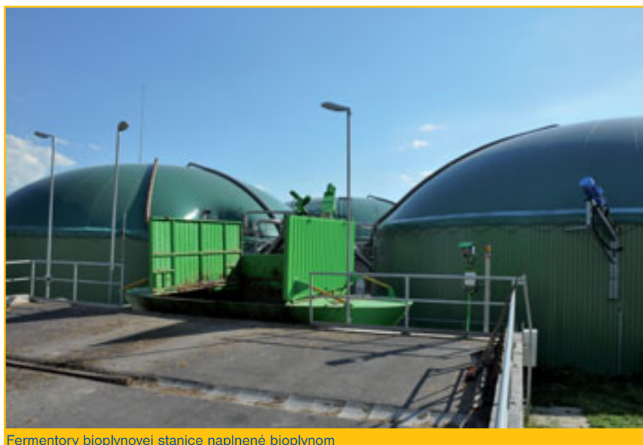
Fermentory bioplynovej stanice naplnené bioplynom
