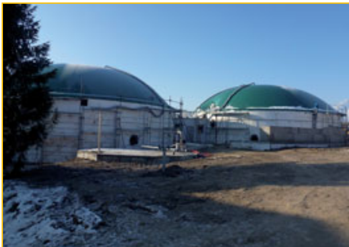
Fermentory bioplynovej stanice naplnené bioplynom
