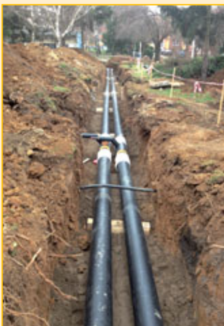
Predizolovaný tepelný rozvod
