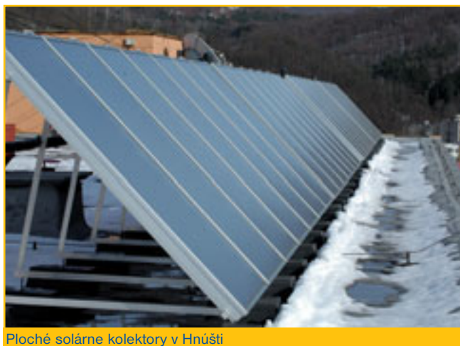
Ploché solárne kolektory v Hnúšti
