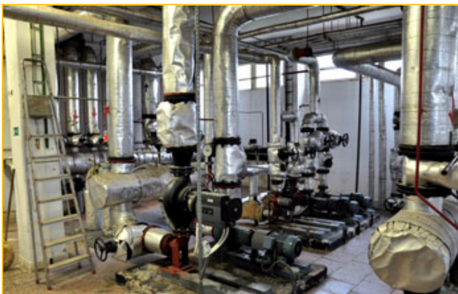
Strojné vybavenie kotolne v Trebišove
