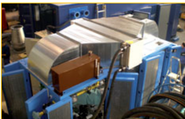
Výmenník vzduch/voda vo vzduchotechnickom potrubí odvetrania KJ
