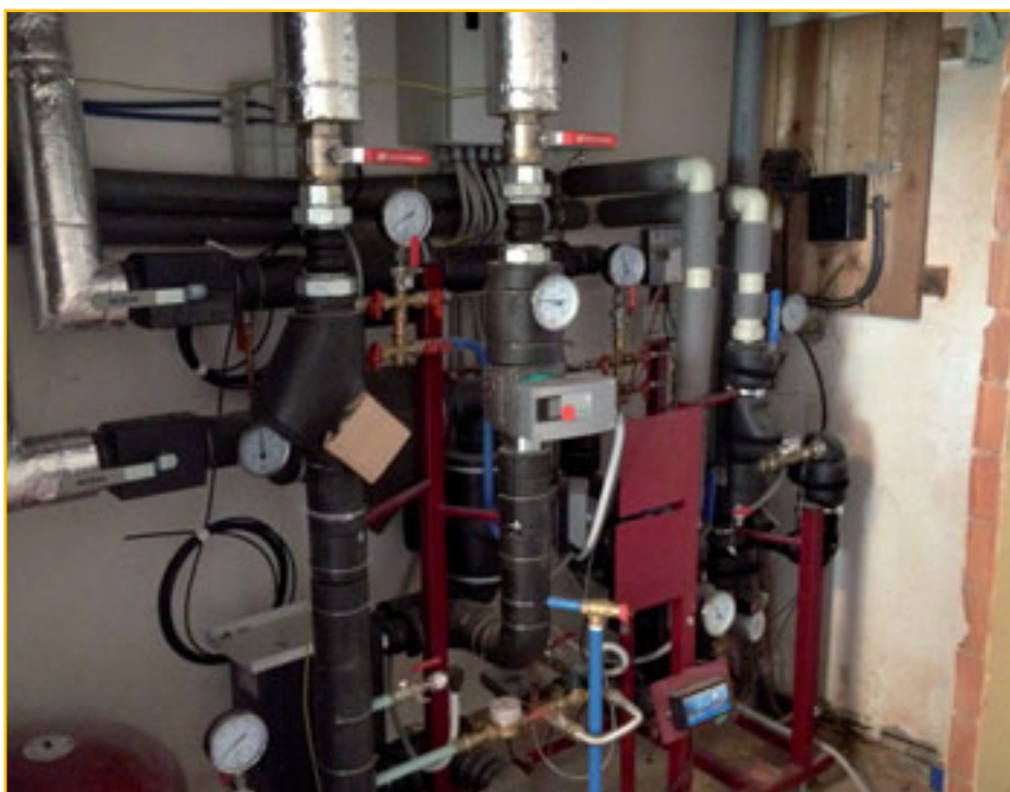
Odovzdávacia stanica tepla v bytovom dome v Poltári (KOST)
