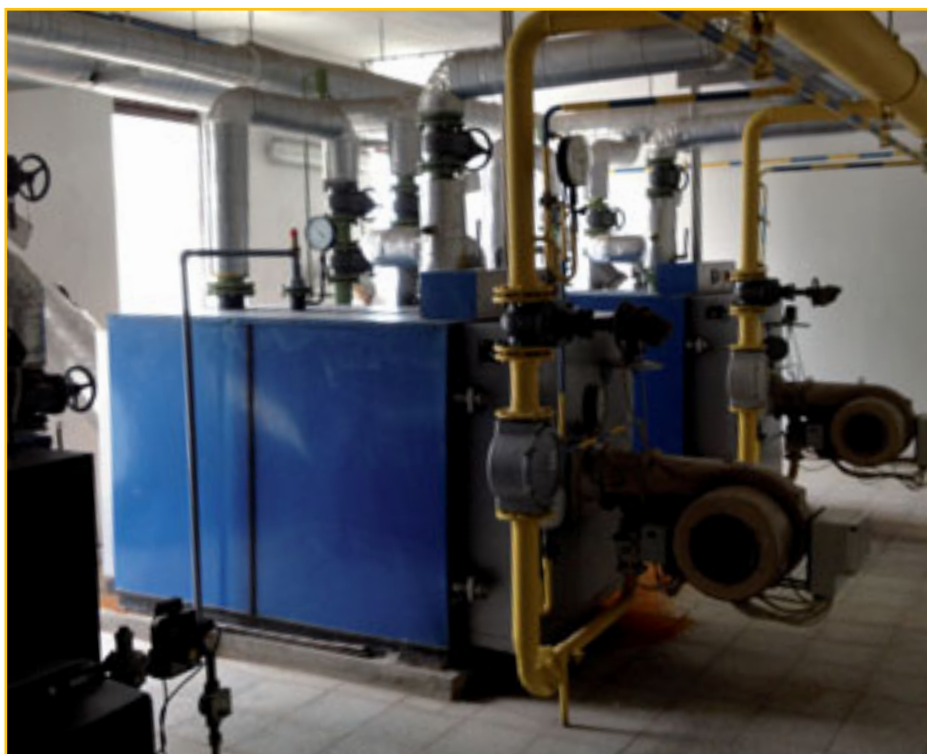
Plynový kotol s pretlakovým horákom v bioplynovej stanici Krahulov
