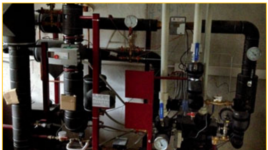
Odvzdávacia stanica tepla v bytovom dome v Poltári (KOST)
