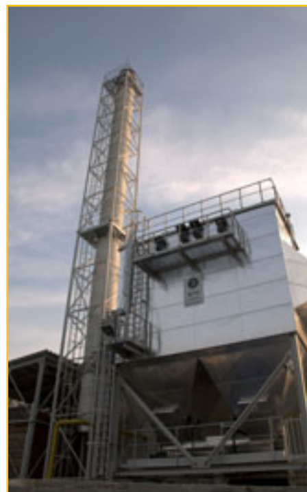
Elektrický odlučovač na biomasovej kotolni vo Vrakuni
