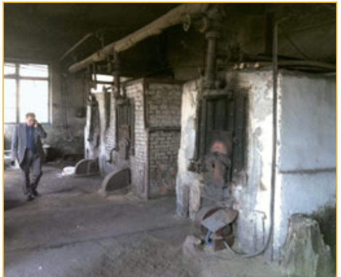
Pohľad do kotolne nemocnice
