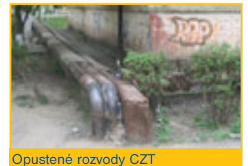
Opustené rozvody CZT
