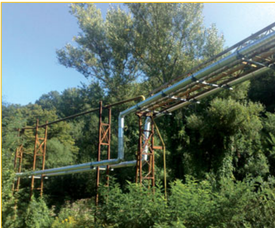
Rozvod tepla prepájajúci priemyselný park s mestským systémom CZT
