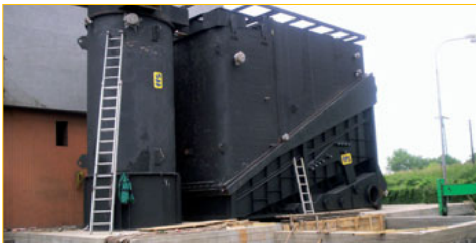
Kotol VESKO-B 6 MW v Partizánskom
