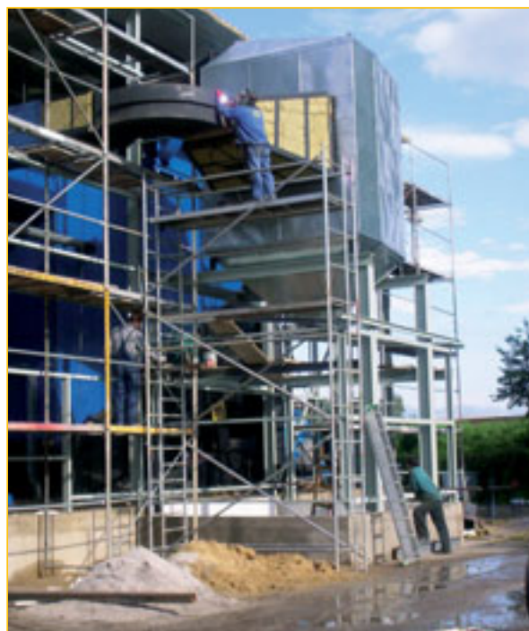
Kotol je umiestnený v novovybudovanej prístavbe
