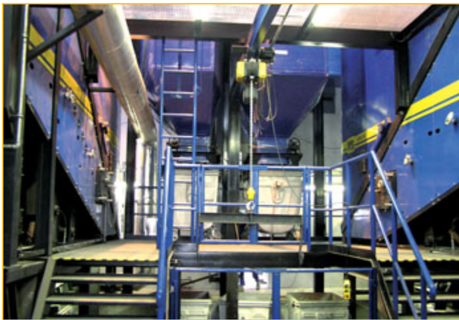
Umiestnenie kotlov VESKO-S v kotolni K8 v Malackách
