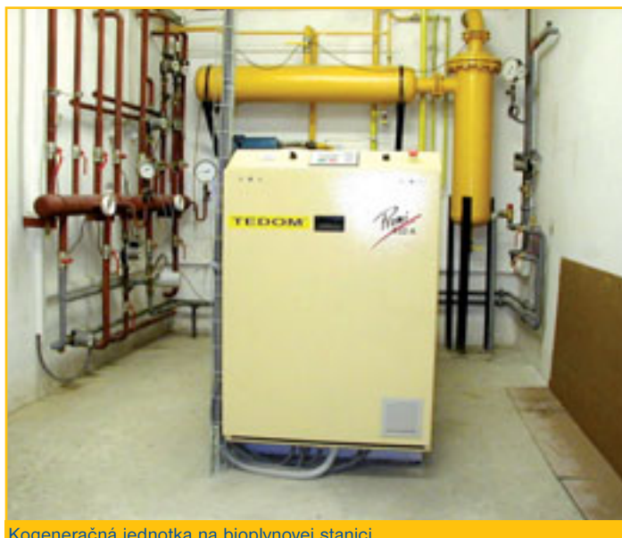
Kogeneračná jednotka na bioplynovej stanici
