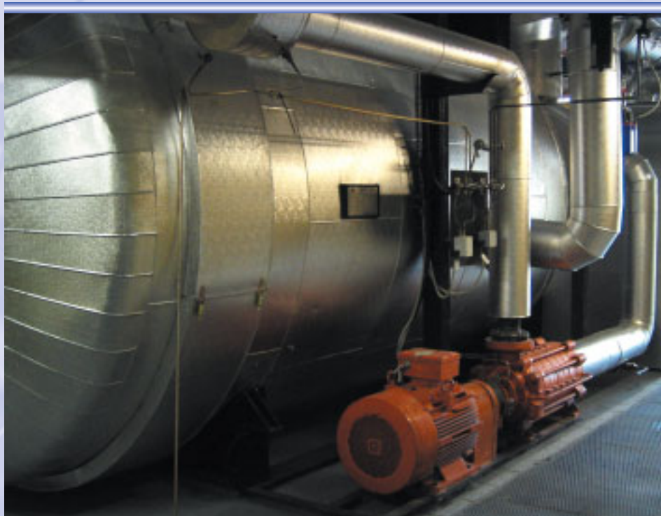
Pohľad na regenerátor a čerpadlo silikónového oleja ORC
