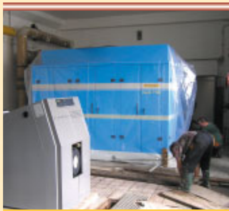
Kogeneračná jednotka v kotolni ČOV
