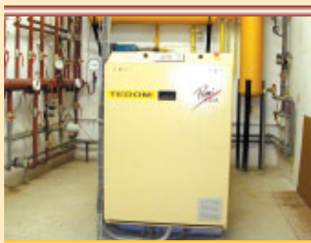
Kogeneračná jednotka v Koliňanoch
