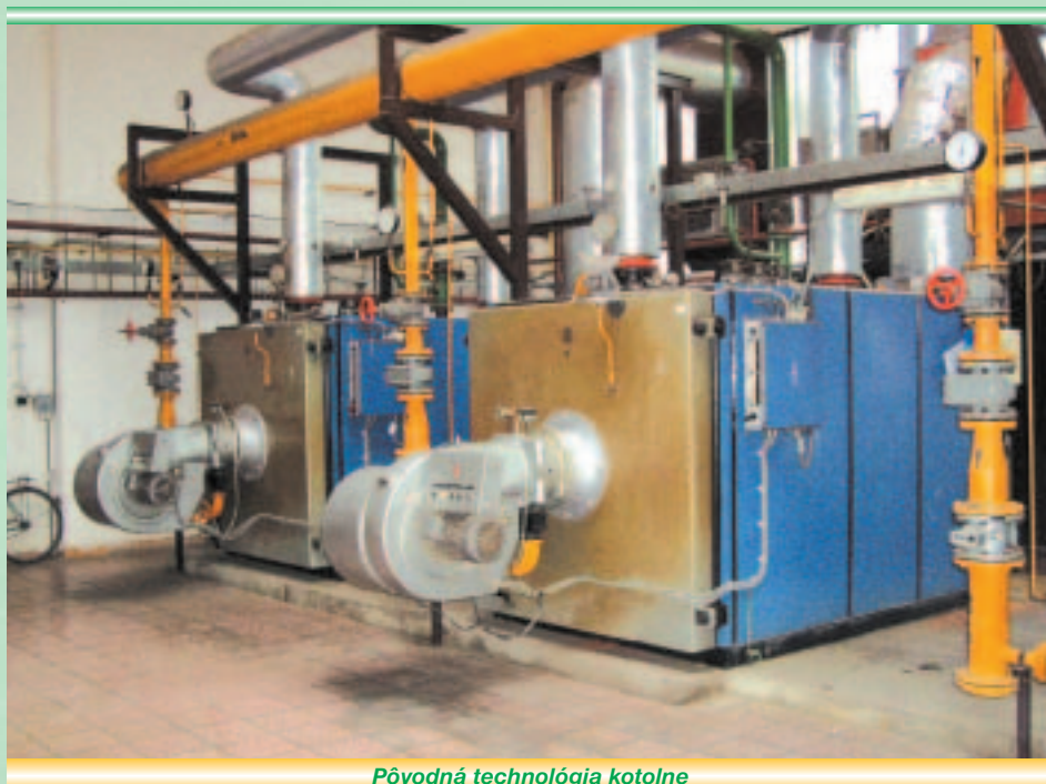
Pôvodná technológia kotolne
