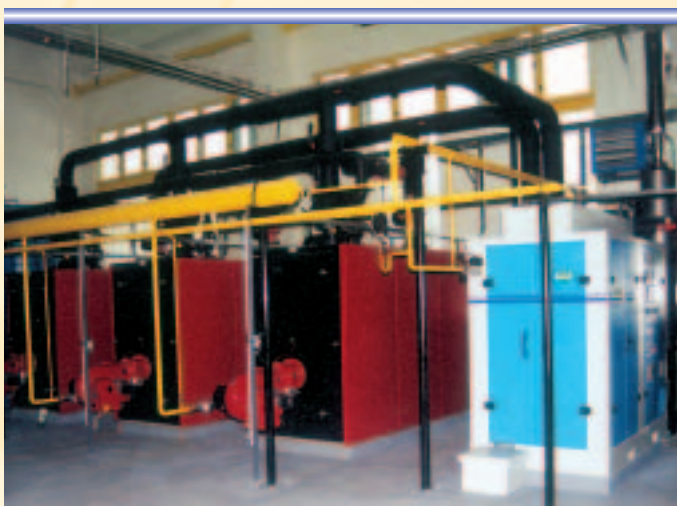
Pohľad do novej plynovej kotolne – vpravo kogeneračná jednotka
