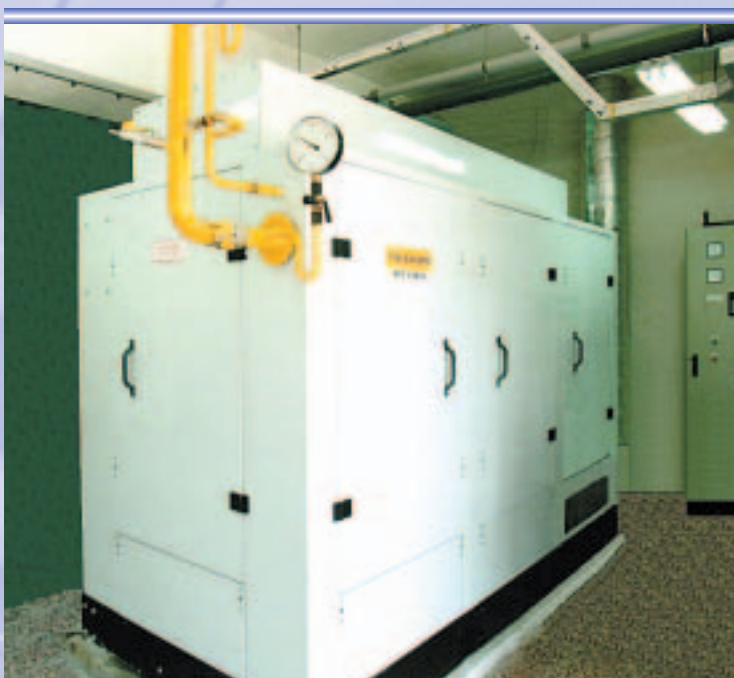
Kogeneračná jednotka TEDOM na plavárni v Banskej Bystrici
