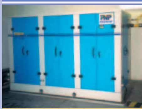
Kogeneračná jednotka v bytovom dome
