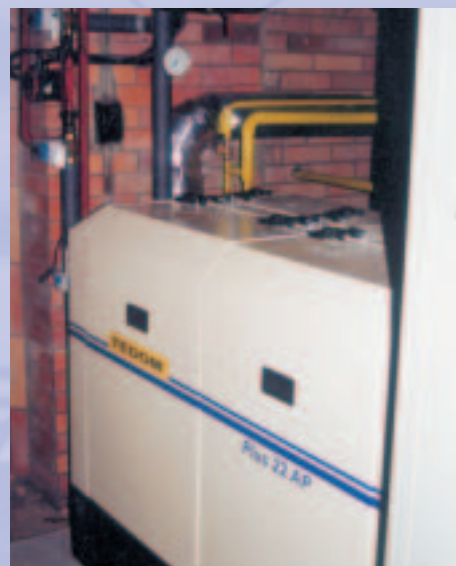
Kogeneračná jednotka v Komárne
