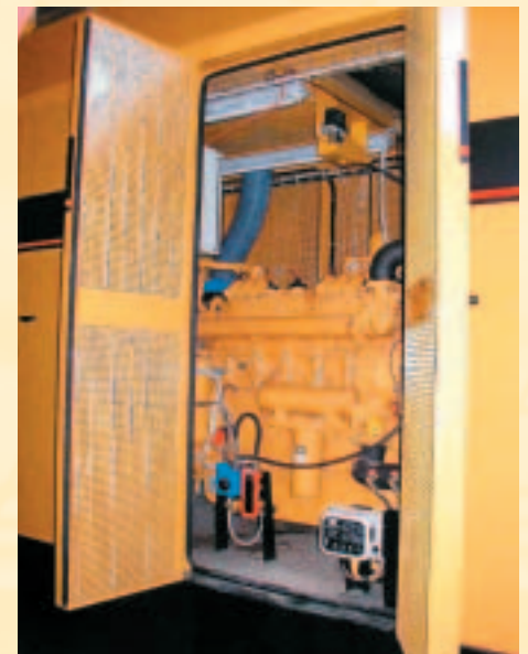
Pohľad na motor kogeneračnej jednotky
