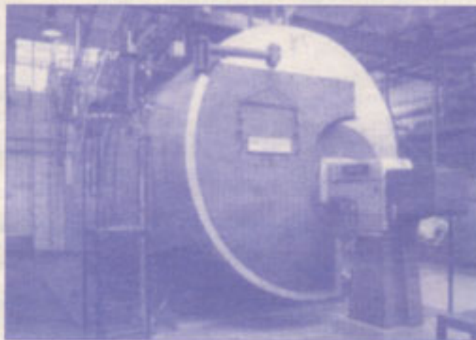
Kotel ORO 16 SA inštalovaný vo firme Kovoľuty Krompachy
