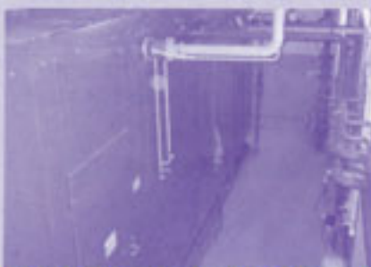
Pohľad na kogeneračnú jednotku
